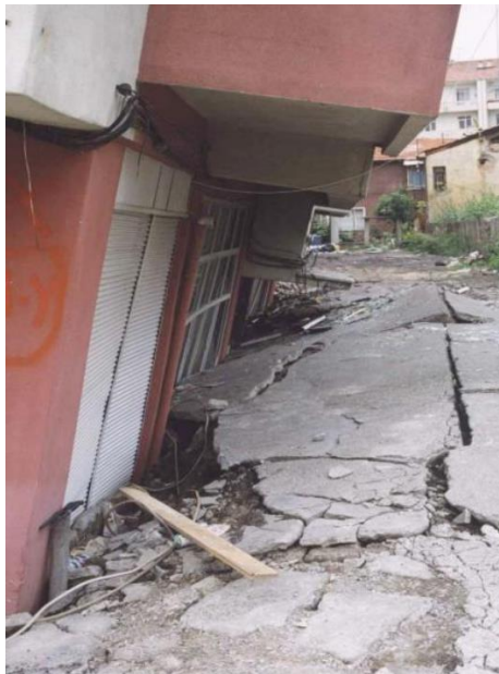
Figura 7 – Exemplo de rotura por falta de capacidade resistente [8]
